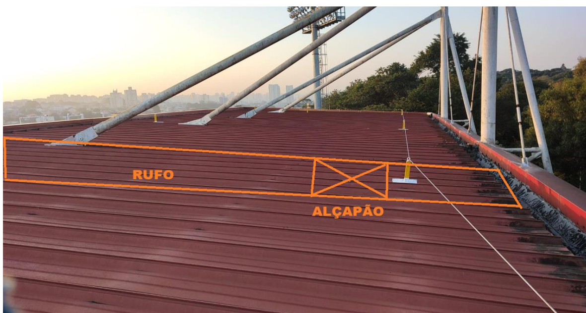
Figura 3: Mostra o padrão das telhas do local e a necessidade de alçapão e rufo de água furada.
