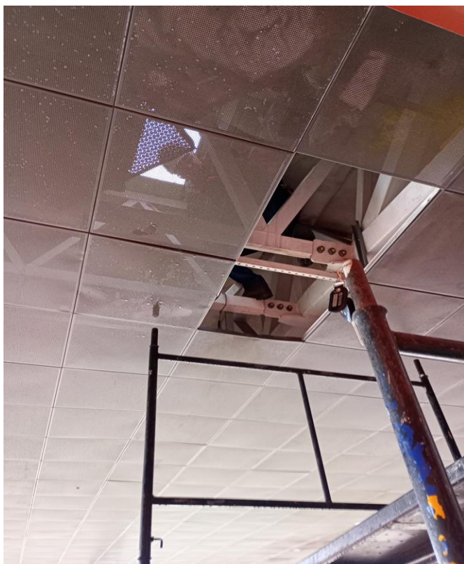
Figura 4: Mostra a necessidade de uma plataforma, em estrutura metálica de apoio ao acesso à cobertura.
